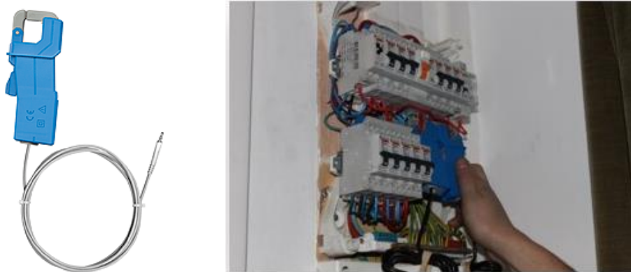
Figure 7 : Pince ampèremétrique et son installation dans un tableau électrique
