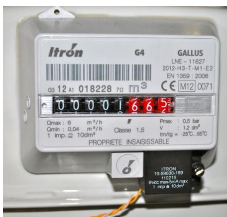
Figure 9 : Instrumentation d'un compteur de gaz avec un émetteur d'impulsions Itron G4 Gallus
